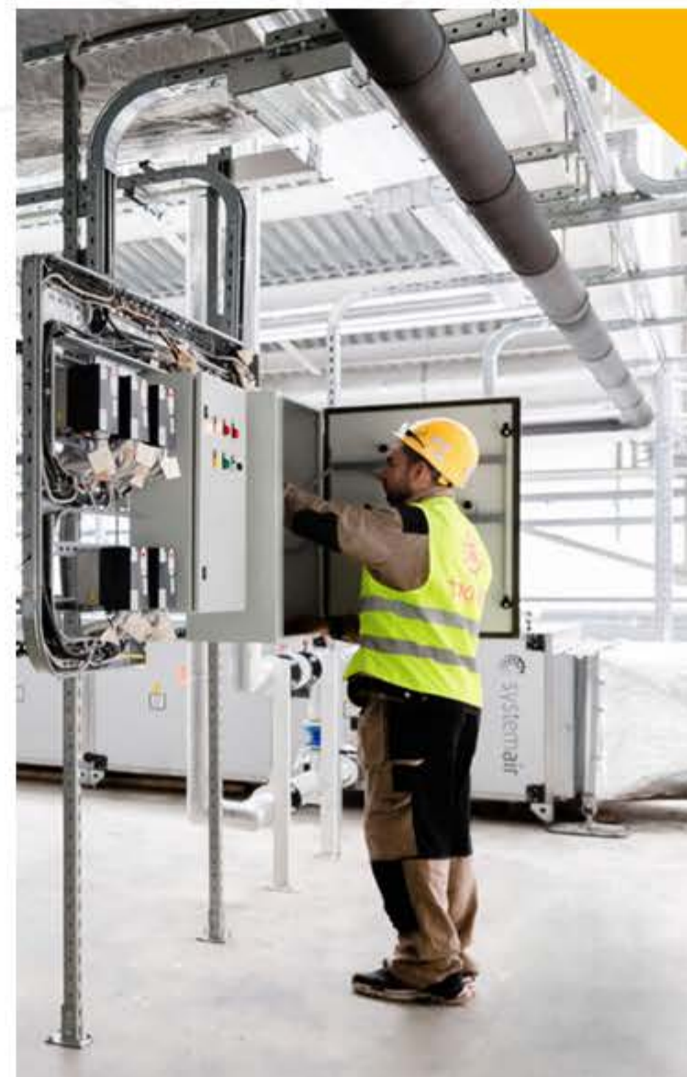
Вентиляция и кондиционирование
