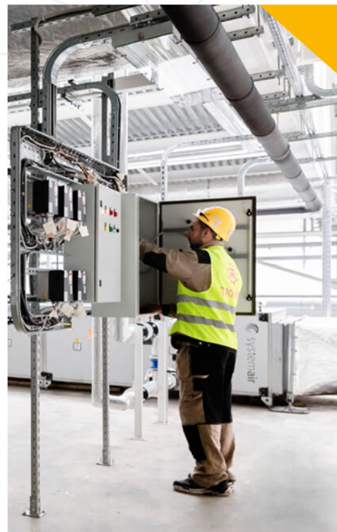
Вентиляция и кондиционирование
